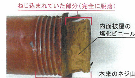
異種金属接合部ネジ山近影（継手断裂部・断面） 漏水当時：築18年・14階建て・154戸（VLP使用物件）
