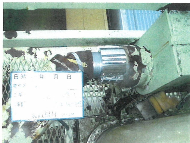
高架水槽二次側 PT-125DS
